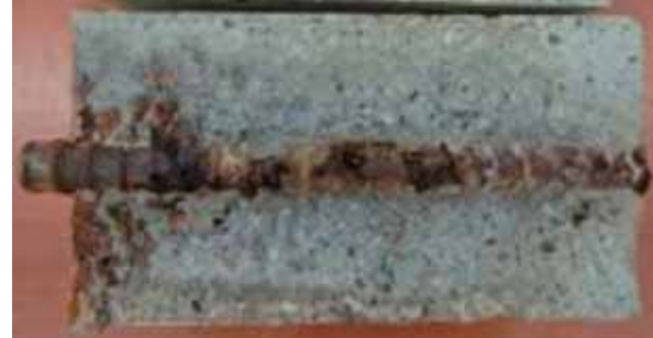
無塗布 鉄筋に腐食が見られる
