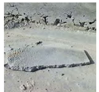
床版のケレン容易で軽く剥離可能
