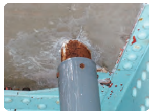
排水桝からの漏水
