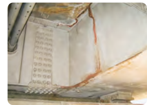
床版と主桁界面の腐食
