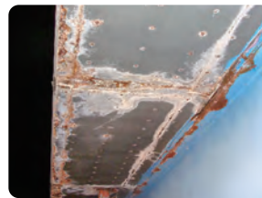
グレーチング床版パネルの腐食
